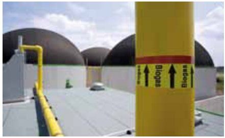
Gasleitung einer Biogasanlage
