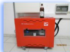
Stromspeicher im Keller eines Einfamilienhauses
