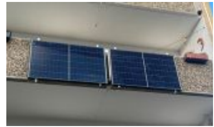
Abb 13 — Das Modul wurde unterhalb des Balkons mit einem Winkel und einem Stahlseil zusätzlich gegen Wind gesichert. •
