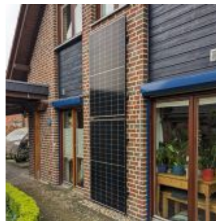
Abb 1 — Die Steckersolaranlage unseres Mitglieds Anne Bussmann wurde nachträglich installiert und produziert seitdem Strom für das private Hausnetz — ohne eine Einspeisevergütung zu erhalten. Es kann dazu führen, dass die Einspeisevergütung für die gesamte Dachanlage sinkt •
