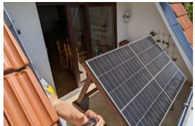
Abb 3 — Der Aufstellwinkel beträgt 48 Grad. Die Lichtausbeute ist vor allem im Frühjahr, Herbst und Winter dadurch optimiert. •
