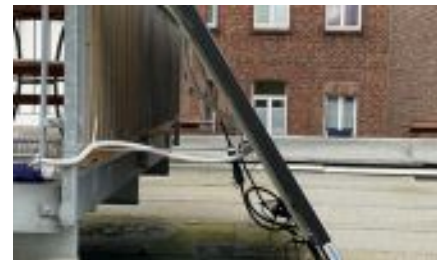
Abb 16 — Die Kabel werden mit Kabelbindern an Unterkonstruktion und Balkon entlang bis zur Steckdose geführt. Zum Schutz dienen Wellrohre aus dem Baumarkt. •
