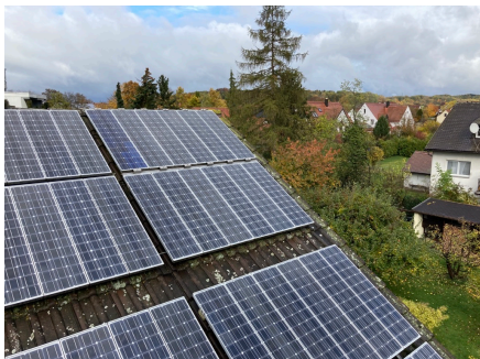
PV-Anlage von 1991! Immer noch in Betrieb!
